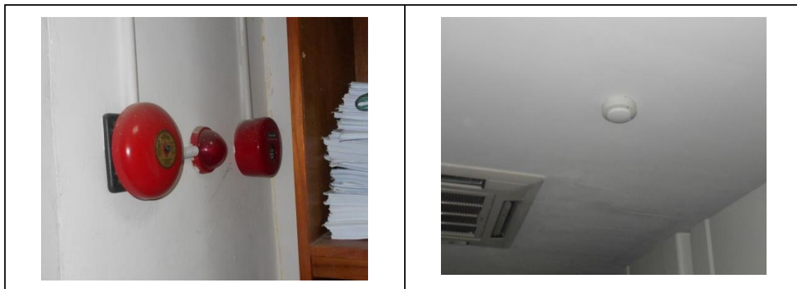
Figura 8 – SISTEMA DE ALARME CONTRA INCÊNDIOS - CAVE
